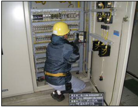
〈排水設備（電源装置点検）〉
