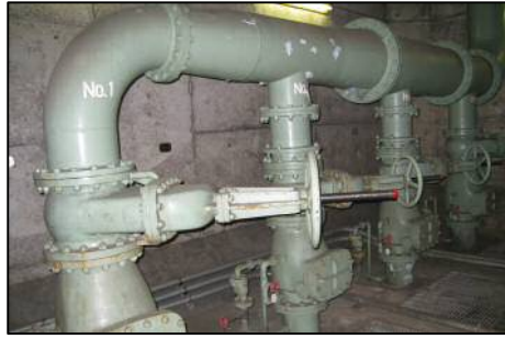
〈国道298号 小山排水機場〉
