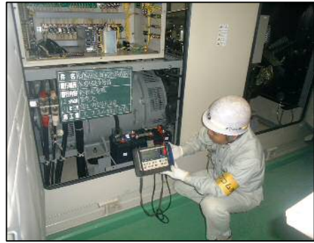
〈発電設備（蓄電池等点検）〉
