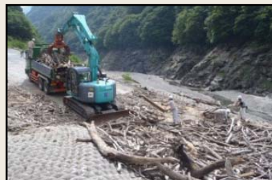
▲流木処理の状況
