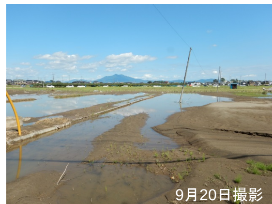
④水田の被災状況
