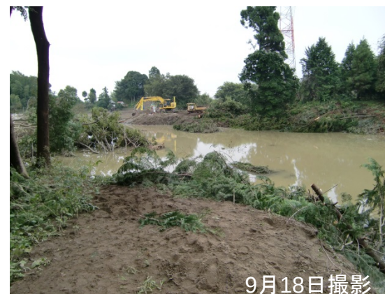
⑤溢水箇所(24.75k付近)排水前
