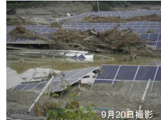
②溢水箇所(25.35k付近)被災状況
