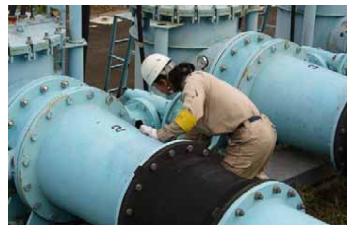
老朽化施設の増大 (施設点検状況)
