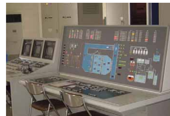
ゲート・ポンプの確実な操作
