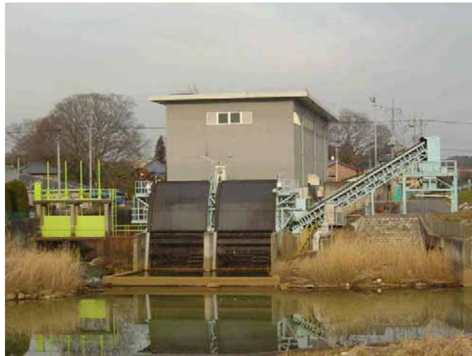
伊丹排水機場
