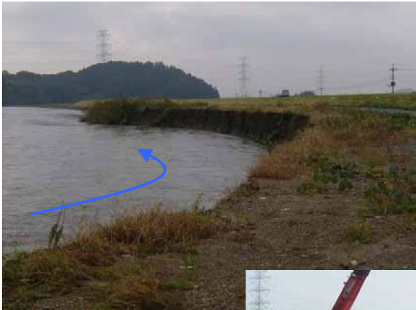
平成 16 年 10 月台風 23 号出水による 河岸洗掘状況 （右岸 69.8km 二宮町反町地先）
