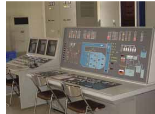
排水機場内の中央操作室
