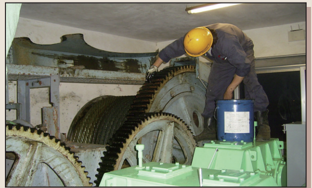
▲機械設備の点検状況
