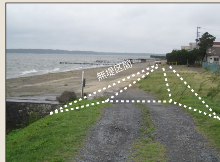
▲無堤部の状況(北浦右岸 釜谷地区)
