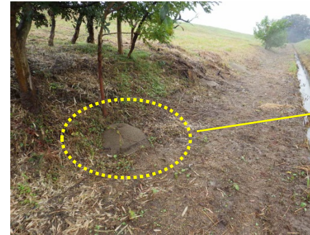
漏水(噴砂あり)
