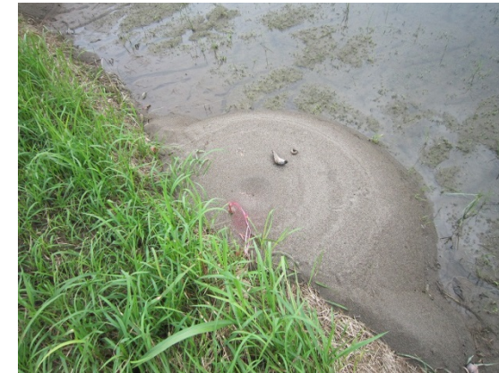
漏水(噴砂あり)
