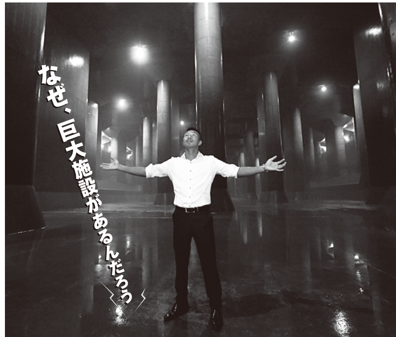
「地下神殿」とも呼ばれる調圧水槽は長さ177m、幅78m、高さ18m。サッカーグラウンド2面ほどの広さに59本の大柱が並んでいます。世界王者の内山さんを圧倒するほどの迫力です
