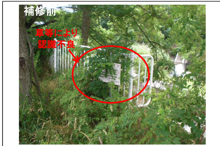
注意喚起看板が草等により認識不良
