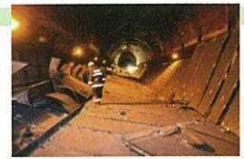
平成24年12月2日 中央自動車道(上り線) 笹子トンネル天井板落下事故
