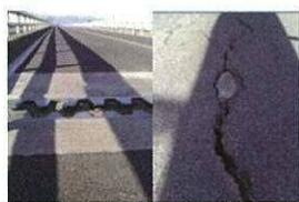
平成23年3月11日 東日本大震災 道路・橋の破損 (左:伊勢崎支部 右:桐生支部)
