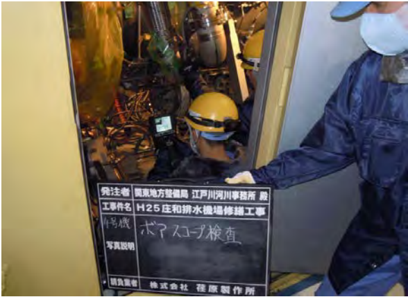
内視鏡による主原動機内の検査状況
