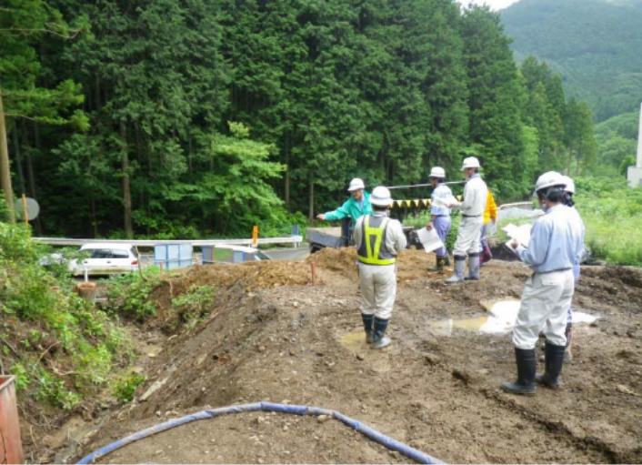
写真-4 設計変更審査会の実施状況=6月18日、H26大久保沢流木対策工事現場
