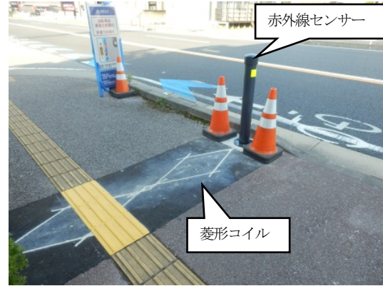
図-5 計測システム設置状況(歩道部)
