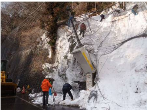
写真-15 下水ポンプの破損
