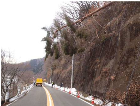
写真-14 倒木状況
