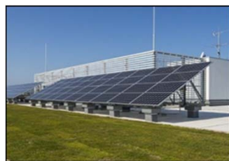
【屋上緑化・太陽光パネル】
