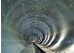
雨水貯留管 (和田弥生幹線 中野区・杉並区)
