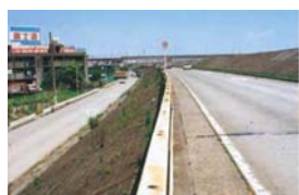
ゼロメートル地帯を守っていた高さ約10mの荒川の堤防
