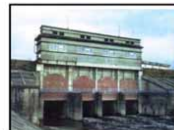
樋門の老朽化
