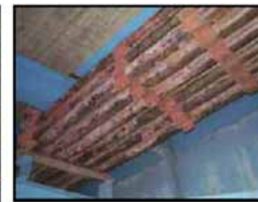
橋梁下面の添架物の腐食
