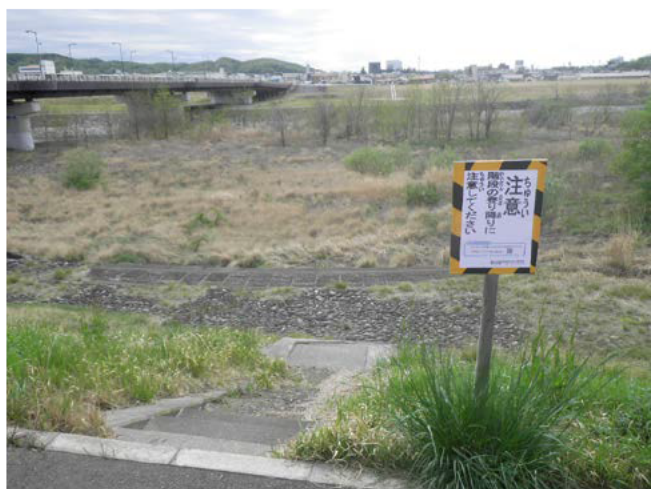
一部老朽化した階段 (告知看板を設置)
