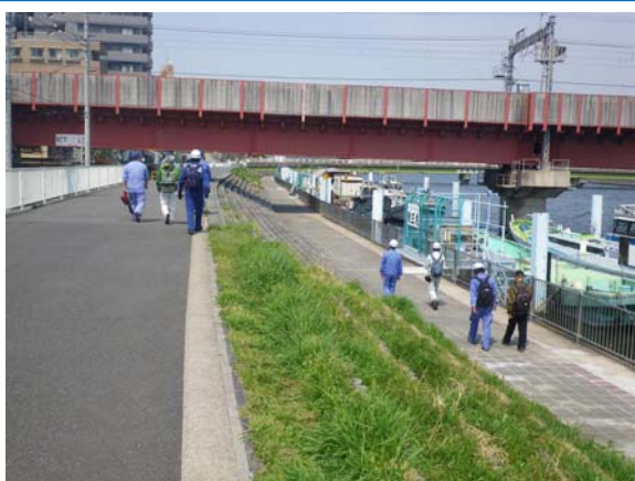
点検風景（鶴見川・生麦付近） 堤防及び護岸（平場）のひび割れや陥没がないか、安全性の観点からチェックします。
