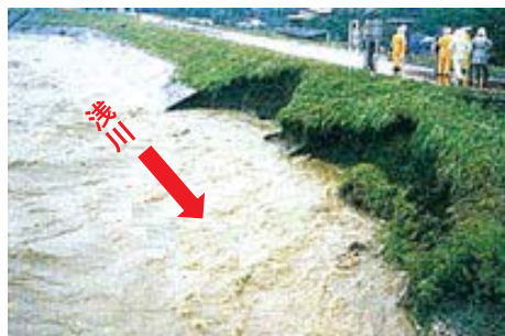
浅川1.2k左岸侵食被害状況
