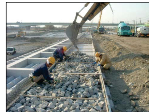
コンクリート殻の利用状況
