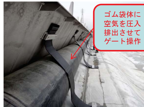
【鋼製起伏ゲート(ゴム袋体支持式)】
