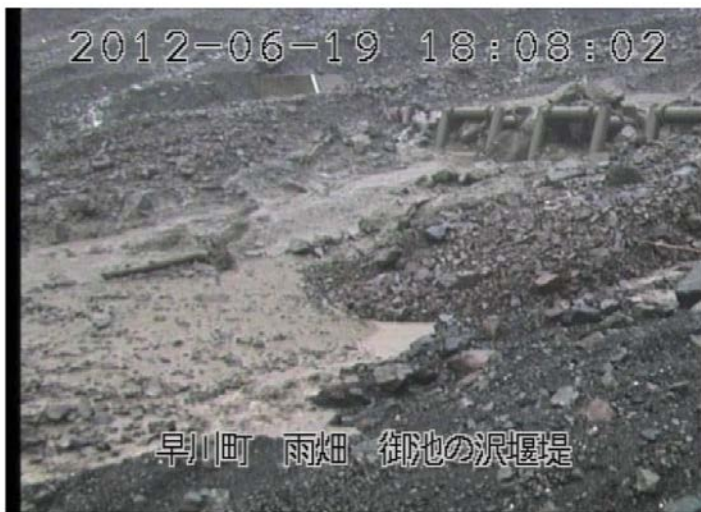
山梨県早川町御池の沢の土砂流出状況(6月19日18時頃撮影)
