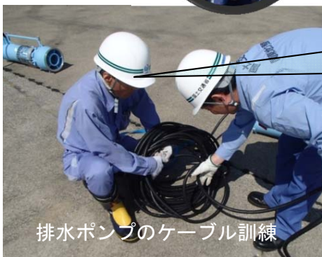
排水ポンプ車の設置訓練
