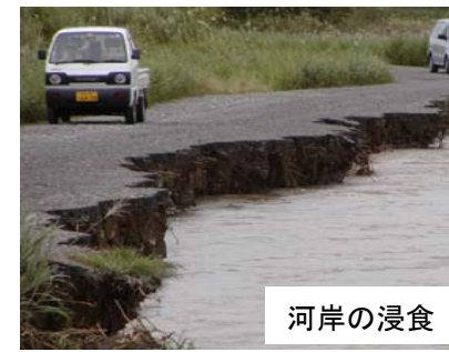
河岸浸食による堤防の崩壊
