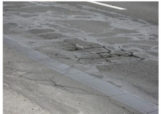
舗装のひび割れ
