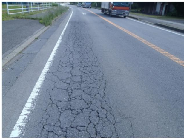
舗装のひび割れ
