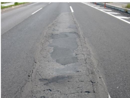
舗装のひび割れ
