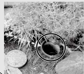
雨水浸透ます
