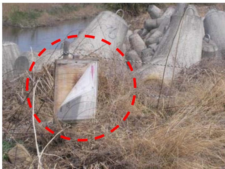
【注意看板の破損、トラロープの張り直し】
