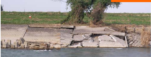
出水による護岸被災状況
