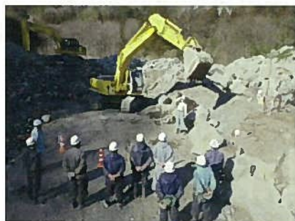
落石事故実験
