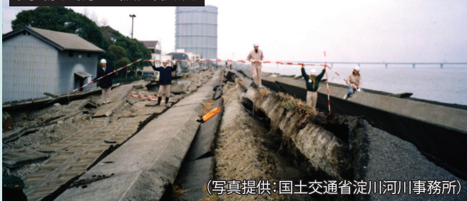
高潮堤防の被災状況
