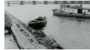
波浪のため破壊された低水路護岸
