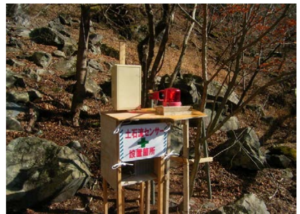
サイレン・回転灯
