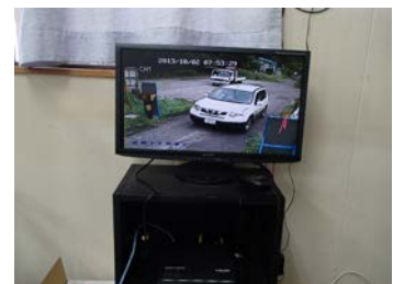
監視装置・モニター
