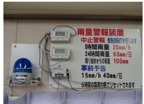
雨量警報装置
