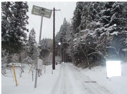
監視カメラ設置状況
