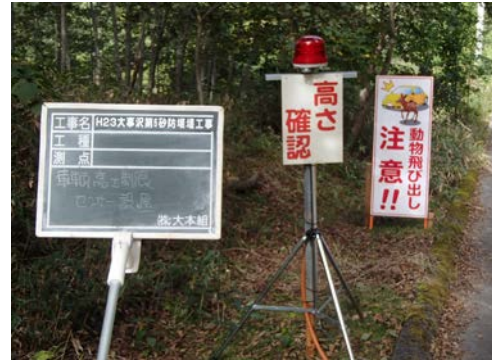
警報回転灯設置状況
