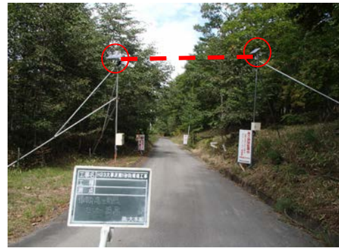
高さ警報センサー設置状況
