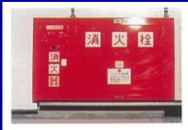
消火器・消火栓
