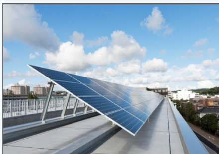
太陽光発電設備の例
