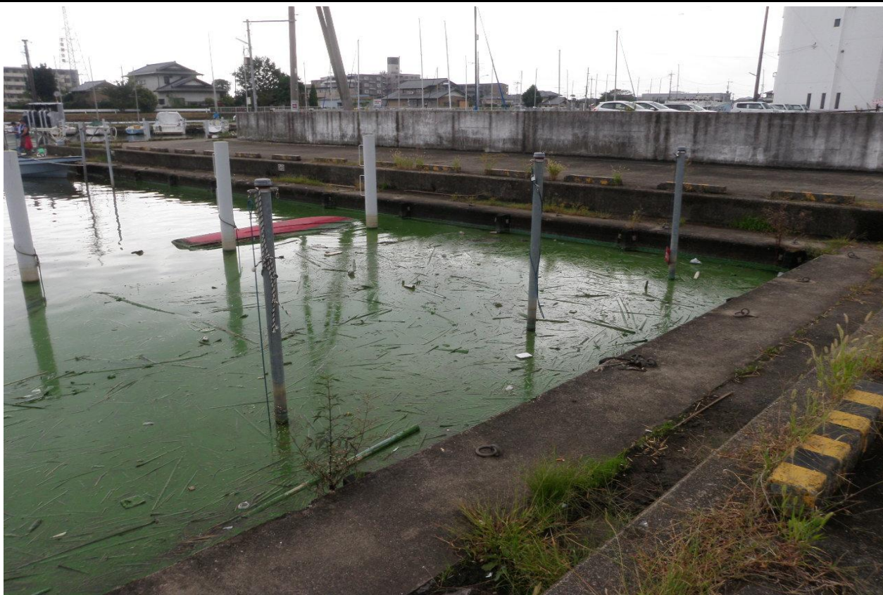
西浦中岸1.50km-150m レベル4 悪臭無し
