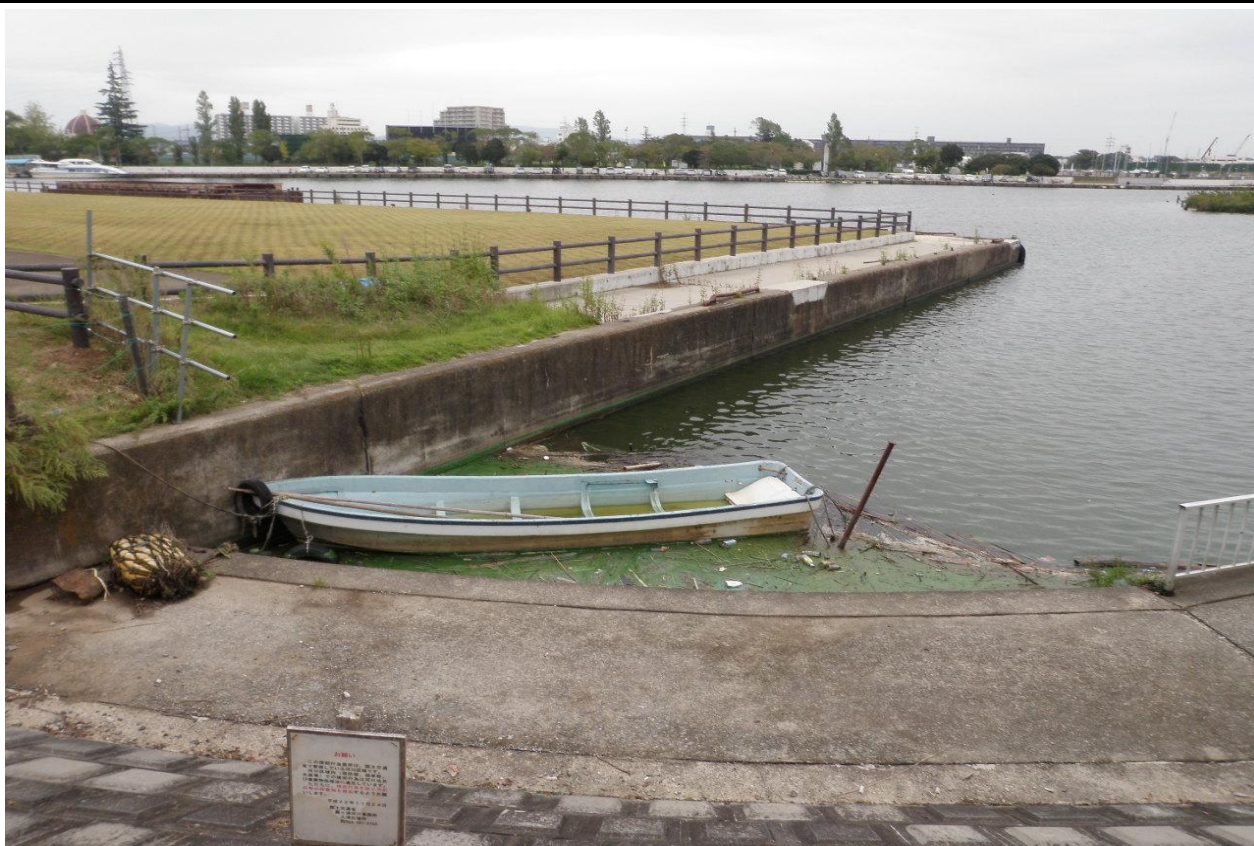
西浦中岸1.00km-50m レベル3~4 悪臭無し
