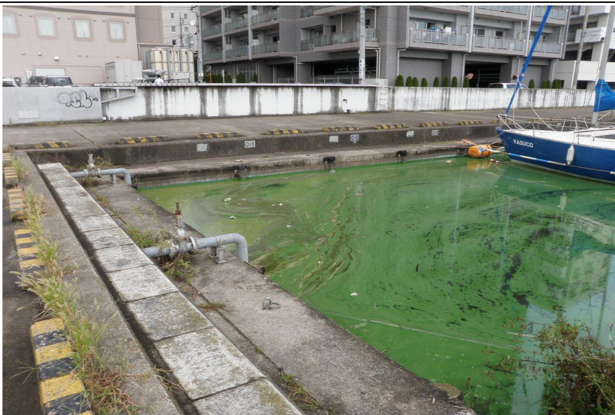
西浦中岸1.25km+200m レベル4 悪臭無し
