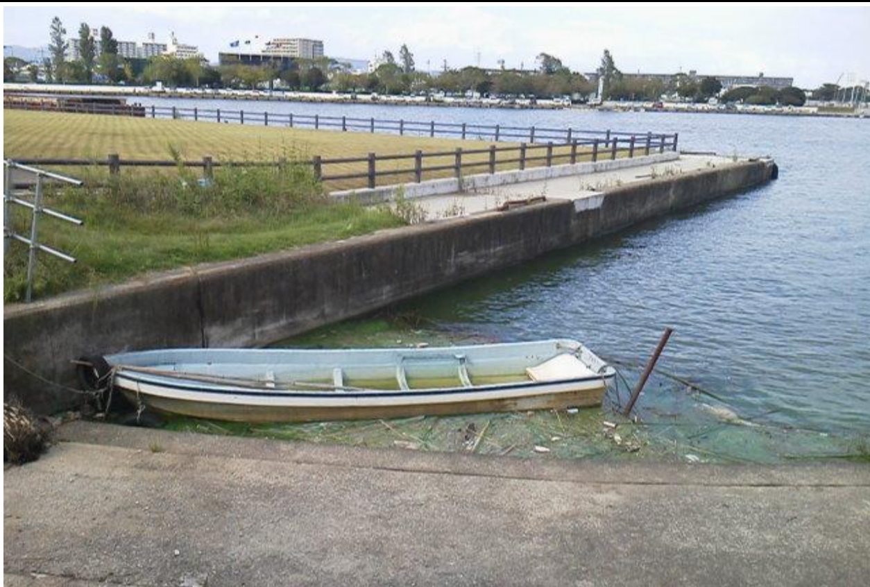
西浦中岸1.00km-50m レベル3~4 悪臭無し
