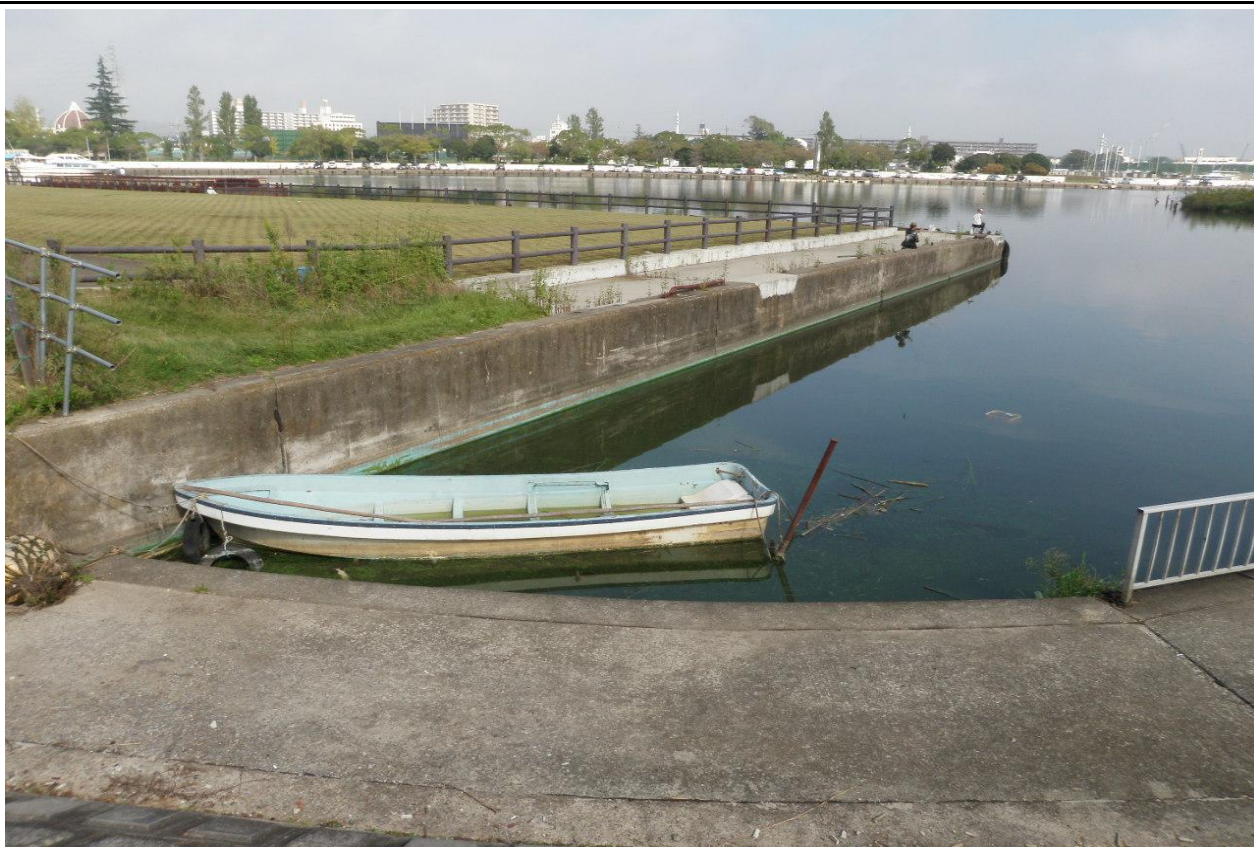
西浦中岸1.00km-50m レベル3 悪臭無し
