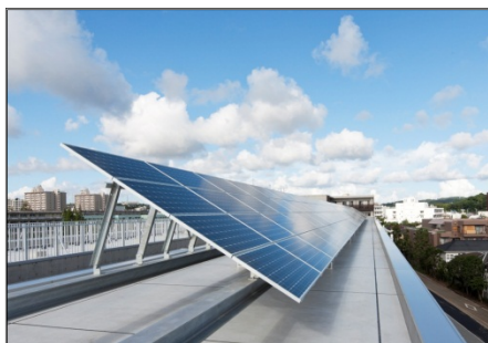
太陽光発電設備の例
