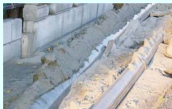
管きよの浮上・破断
