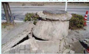
マンホール浮き上がり
