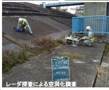
堤防の亀裂の点検
