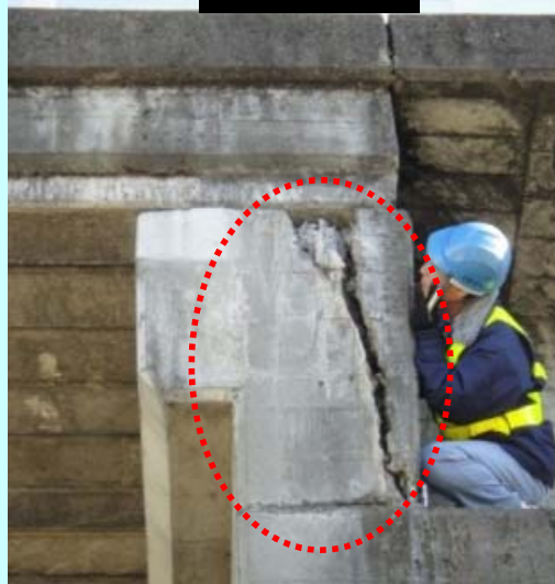
橋脚の損傷(剥離、鉄筋露出)
