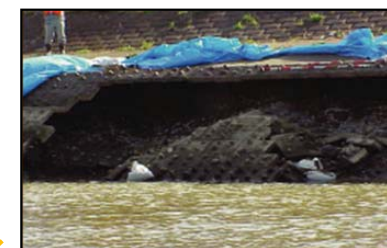
平成11年 法崩れ状況(東京都江戸川区東篠崎)
