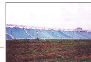
平成10年 法崩れ状況(埼玉県松伏町金杉)
