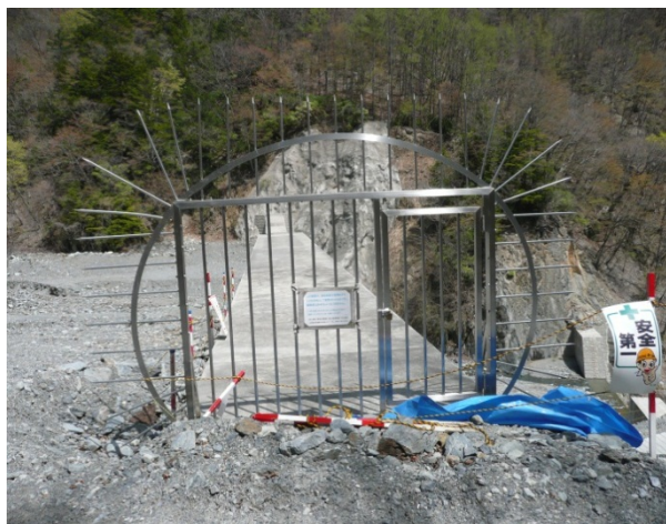
広河内第四砂防堰堤 袖部の立入禁止柵が 開錠されていたため鍵を交換
