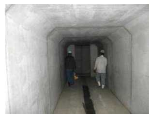
雨水貯留施設(地下式)
