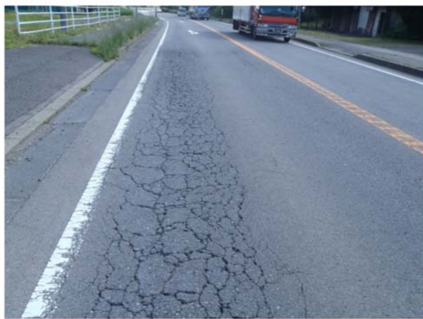
舗装のひび割れ
