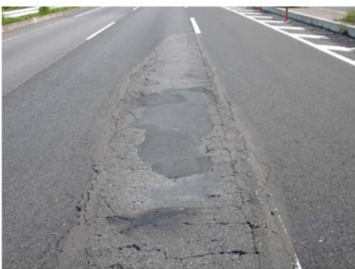
舗装のひび割れ
