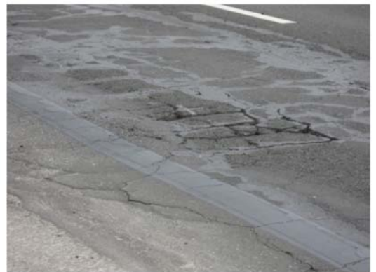
舗装のひび割れ
