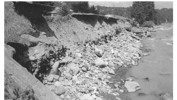
台風15号の被害状況（群馬県嬬恋村三原付近）【転載：群馬の砂防】
