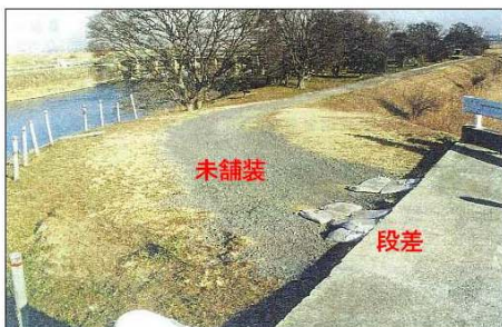
段差があり、未舗装のため歩きにくい遊歩道
