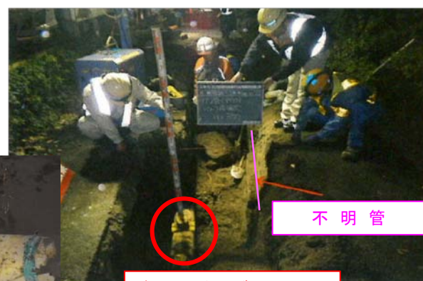
ガス管バルブ損傷箇所
