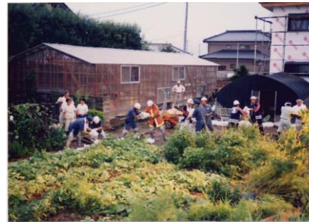
平成10年 江戸川基盤漏水(千葉県 野田市関宿元町の水防対応状況)
