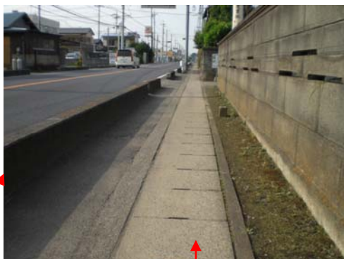
縁石が乗り入れの阻害に
