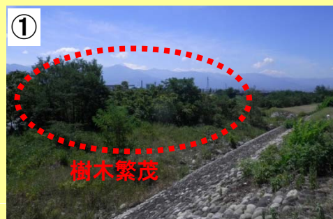
河川監視カメラの画像 樹木により監視の支障となっています。
