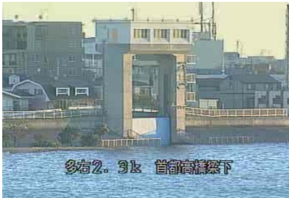
羽田第一水門の閉鎖状況 (10/1 6:00頃 河川管理用カメラ画像)
