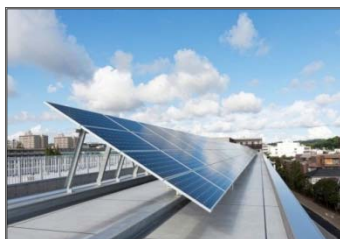
太陽光発電設備の例
