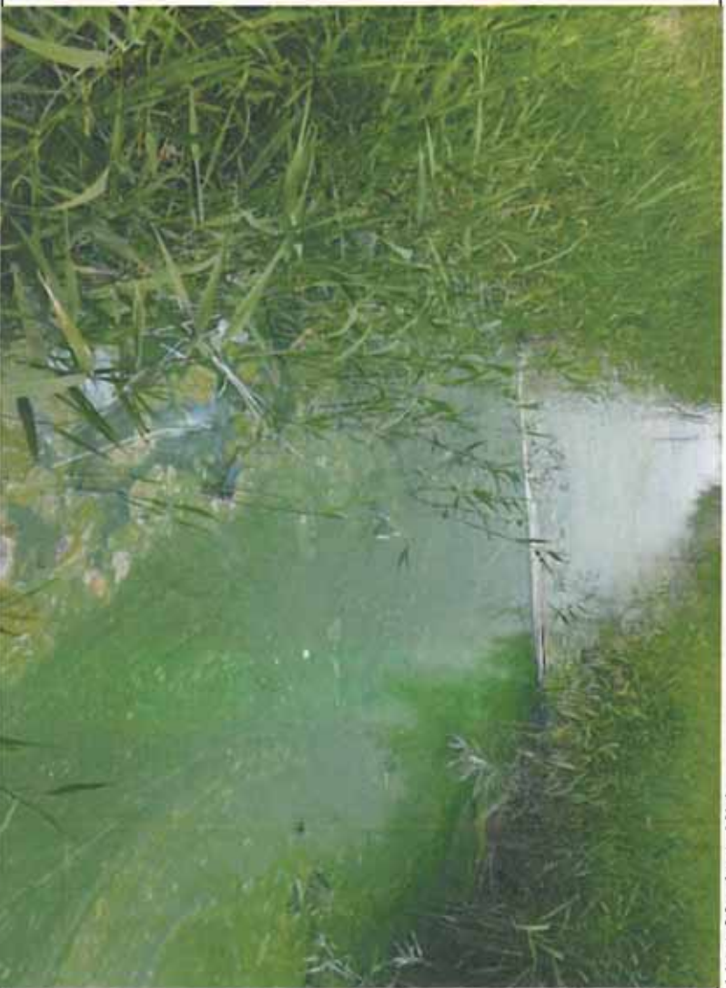
西浦左岸32. 5km—50県植生レベル4～5—無臭・におい有り
